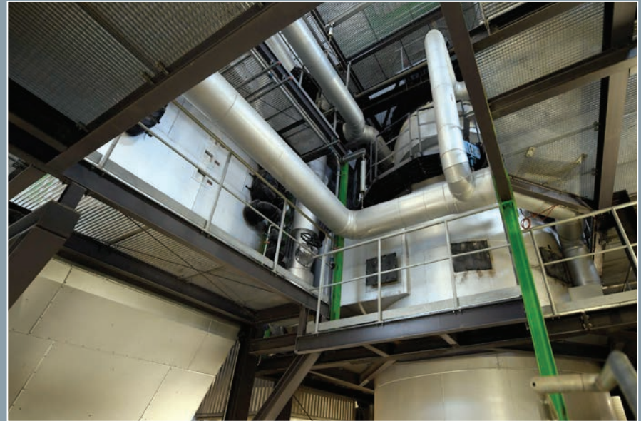
Anlage zum Verbrennen von Holzsnipseln für das Ferwärmenetz im Holzheizkraftwerk Ludwigsburg
