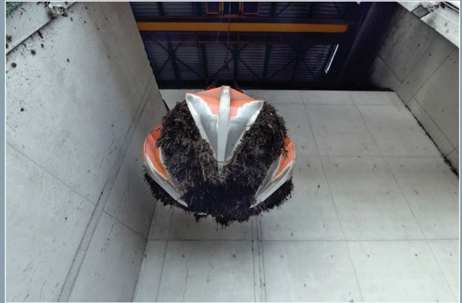
Anlieferung von Holzchnipseln tonneweise per LKW ins Holzheizkraftwerk Ludwigsburg
