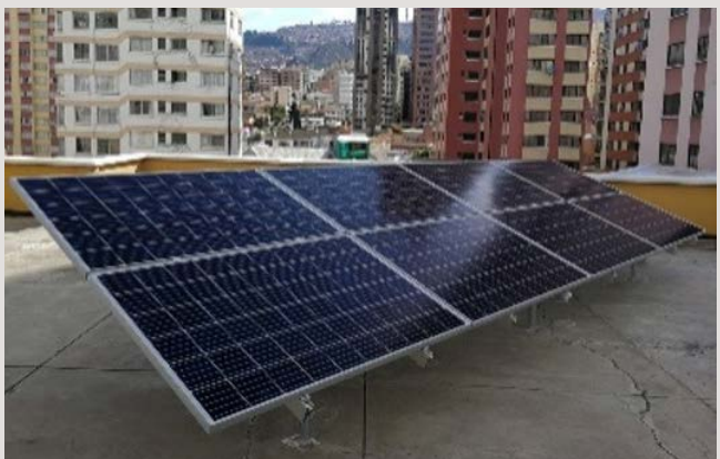
Eine von 18 neu installierten Solaranlagen auf Schulen und städtischen Gebäuden in La Paz / © Verena Schwarte, Stadt Bonn
