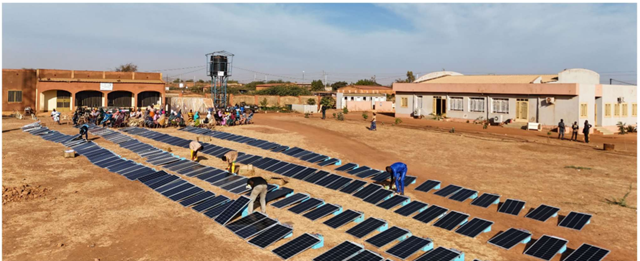
Neue Solarhome-Systeme für 400 bedürftige Haushalte in Kongoussi, die bisher keinen Zugang zu elektrischer Energie haben.
